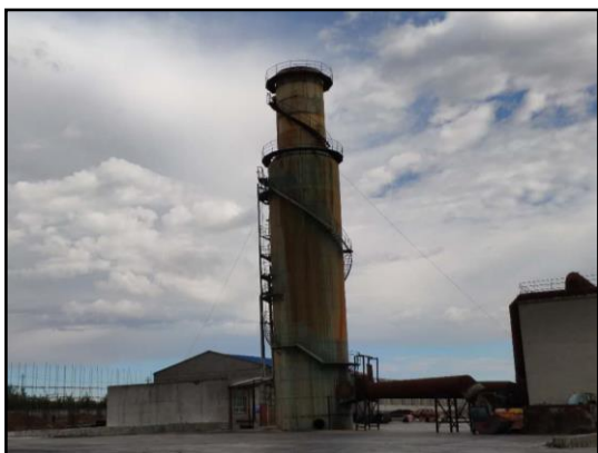
双碱法脱硫塔
