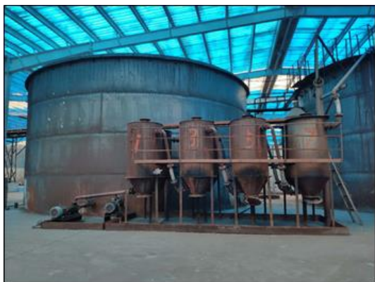
浸泡提金液吸附罐区
