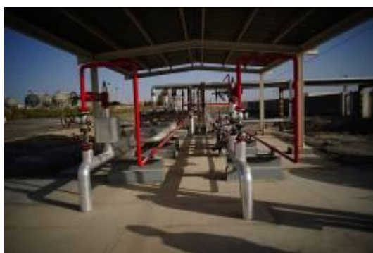
厂区内部管线
