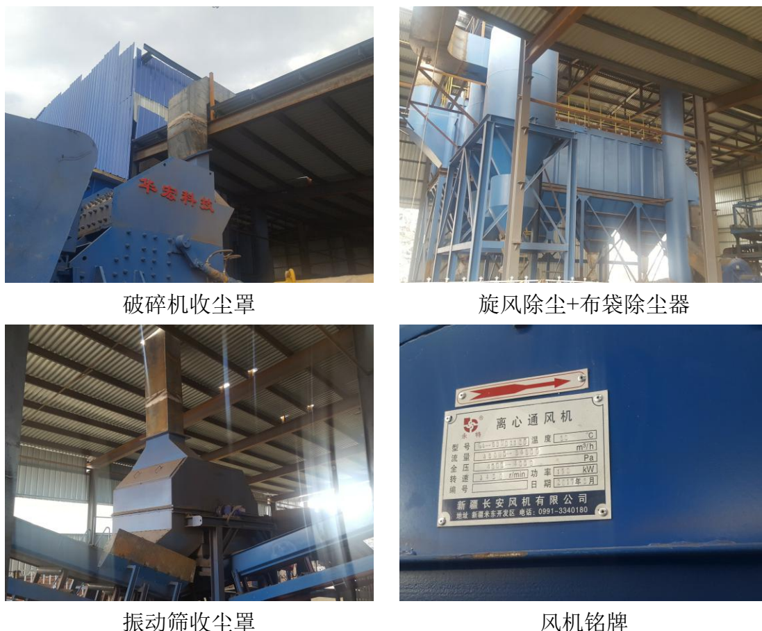
图 2.3-1 废气治理设施
