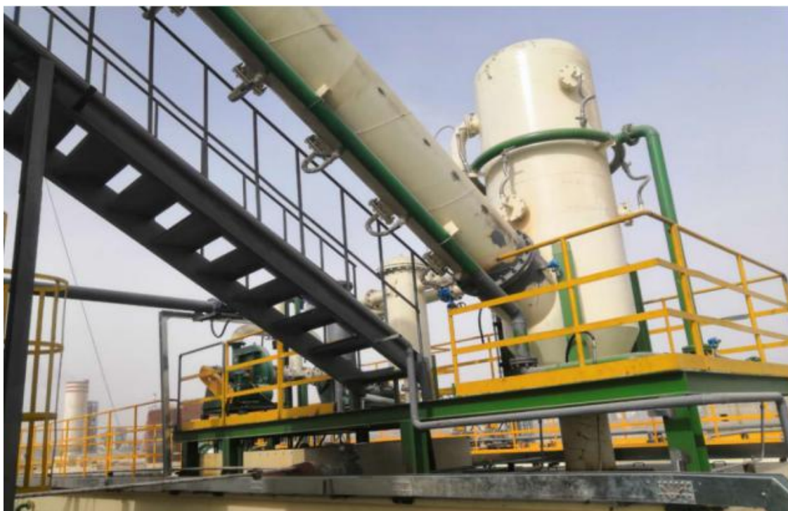
图 3.3-3 热脱附气处理设备装置
