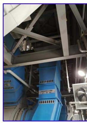
送风机入口管道（消声器）
