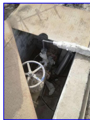
污水站总排口
