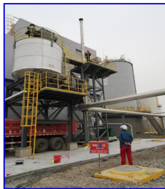
污泥干化排气筒
