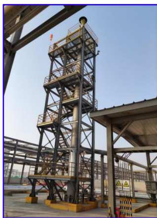
PX 罐洗涤塔
