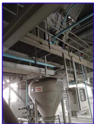
电除尘仓泵（消音器）
