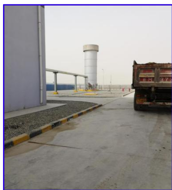
沼气管火炬焚烧塔
