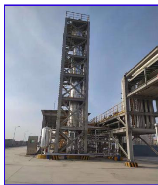
火车卸料站排气筒
