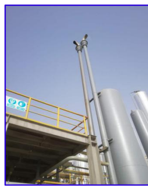
甲醇制氢排气筒
