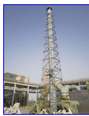
生物除臭排气筒
