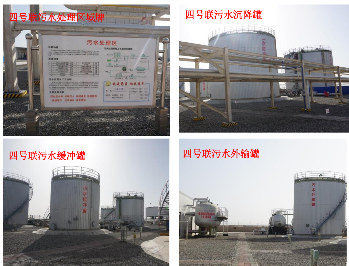
四号联合站采出水污水处理设施照片
