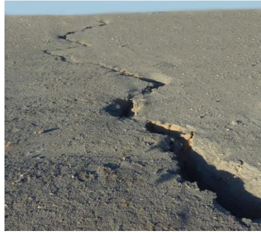
图 3.2-3 地表裂隙（L4）
