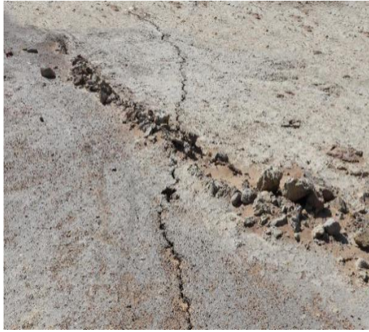
图 3.2-2 地表裂隙（L3）
