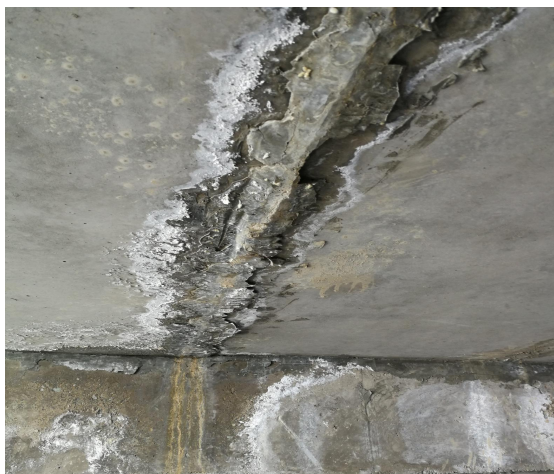
板底渗水开裂
