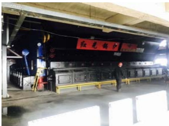
现有工程 130t/h 锅炉
