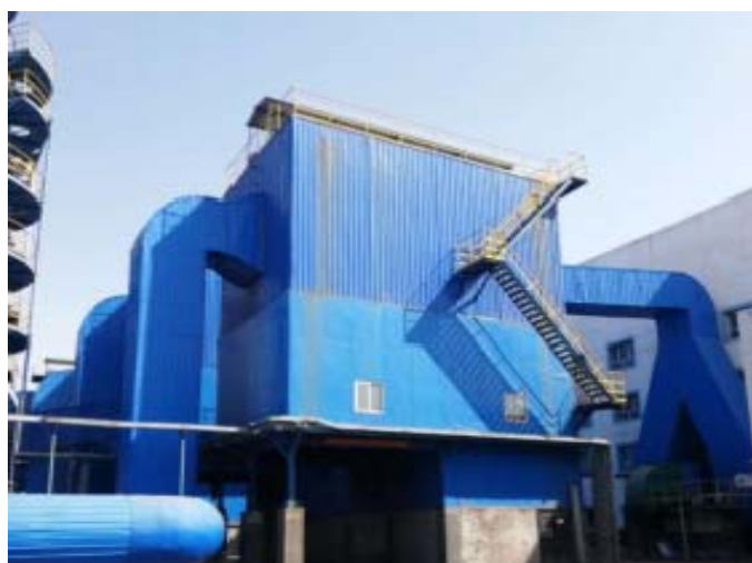
现有工程除尘装置
