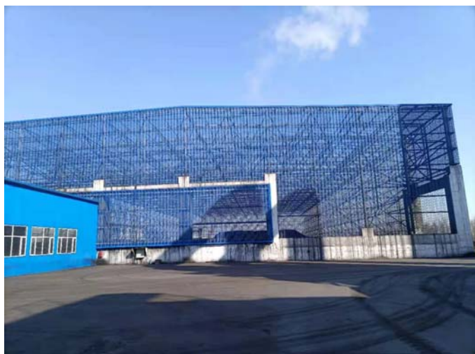
现有工程防风抑尘网
