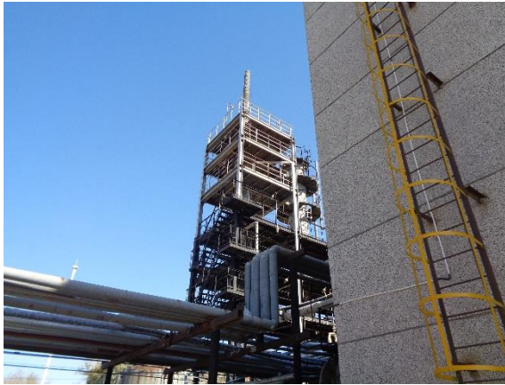
现有硫酸盐装置尾气吸收塔排气筒
