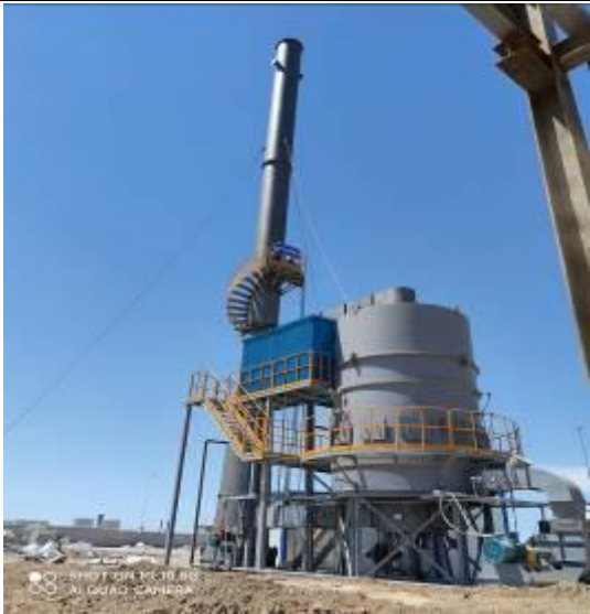
蓄热式焚烧炉
