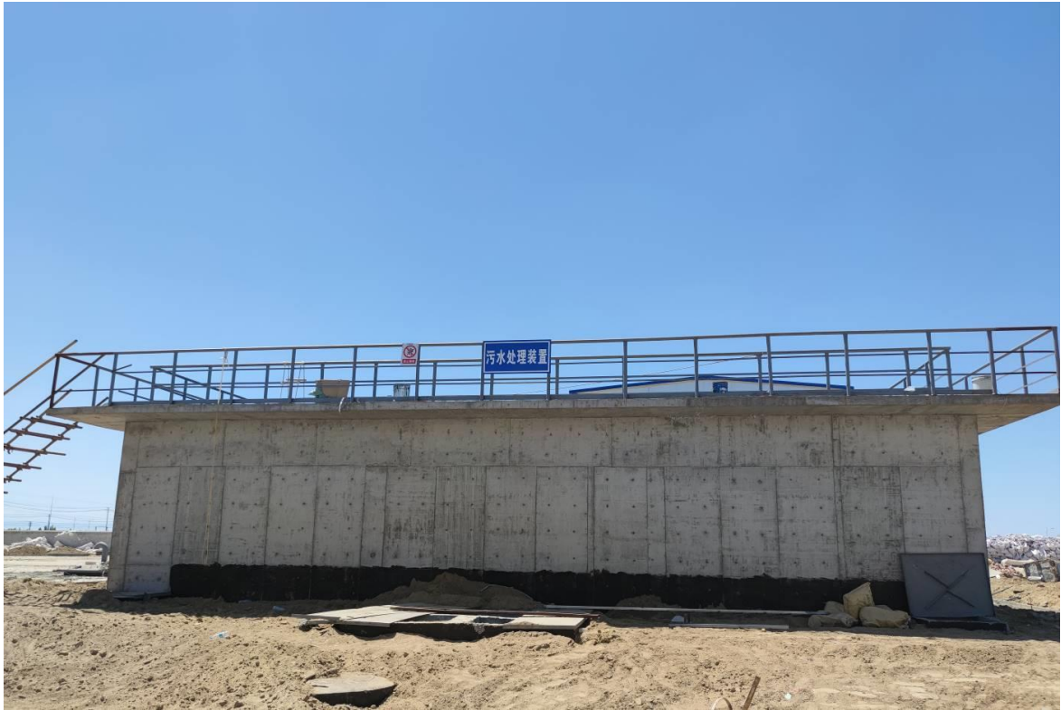
图 4.2-2 污水处理装置
