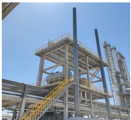
苯乙烯料回收装置
