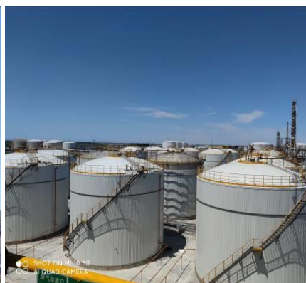
成品储罐罐区
