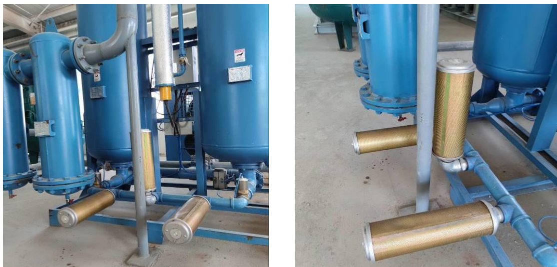
图 4.3-1 压力容器吸附筒消音设施
