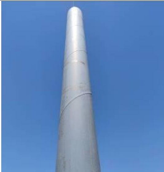
导热油炉排气筒
