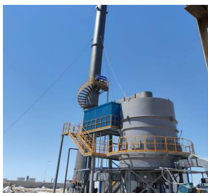
有机废气处理装置
