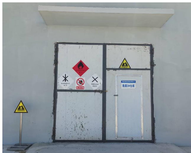
图 4.4-2 危险废物库房大门
