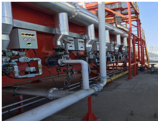
不凝气回炉掺烧装置
