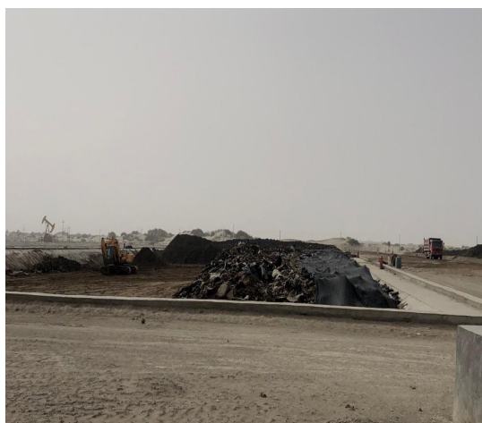
污油泥存储现状
