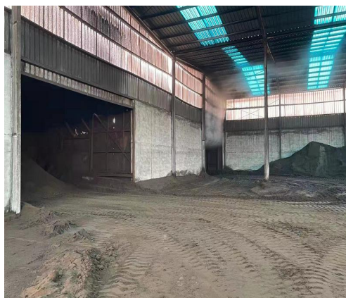
还原土暂存间（下部）
