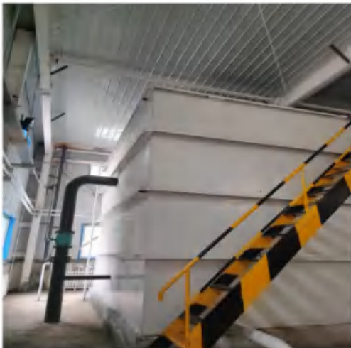
白杨沟丰源煤矿矿井水处理站
