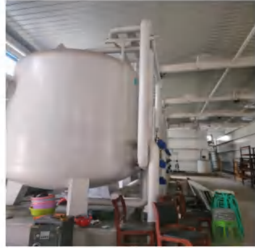
白杨沟丰源煤矿生活污水处理站
