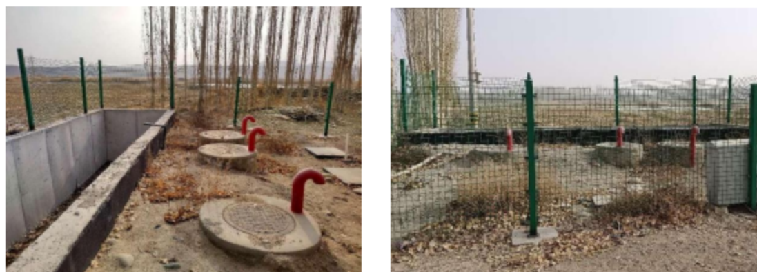
图 4.3-1 拜勒其尔村集中化粪池照片
