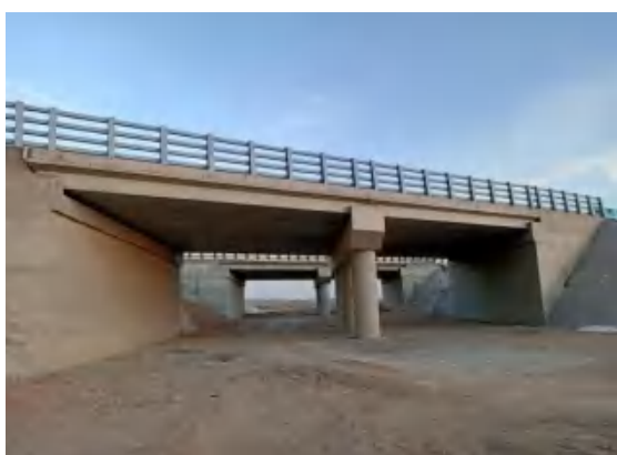
SK25+670.0 桥梁式动物通道
