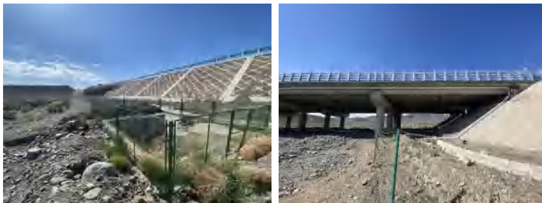
K185+620 伊吾河 2 号大桥径流收集系统、事故池与防撞护栏
