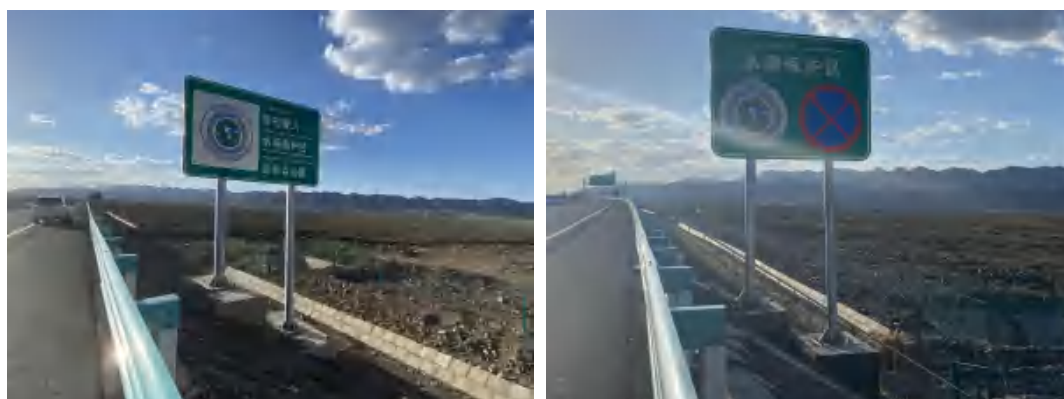
K186+00~K187+500 吐葫芦乡地下水饮用水源地保护区段应急沟、事故池与防撞护栏
