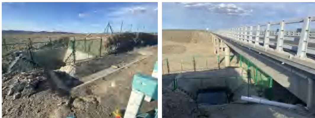
K178+513 小白杨沟 1 号大桥径流收集系统、事故池与防撞护栏
