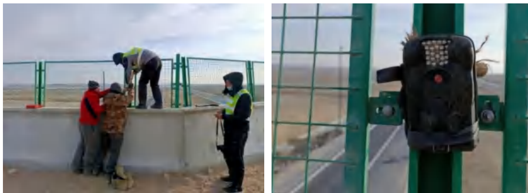
SK61+360 上跨式动物通道 WY-011 相机安装情况
