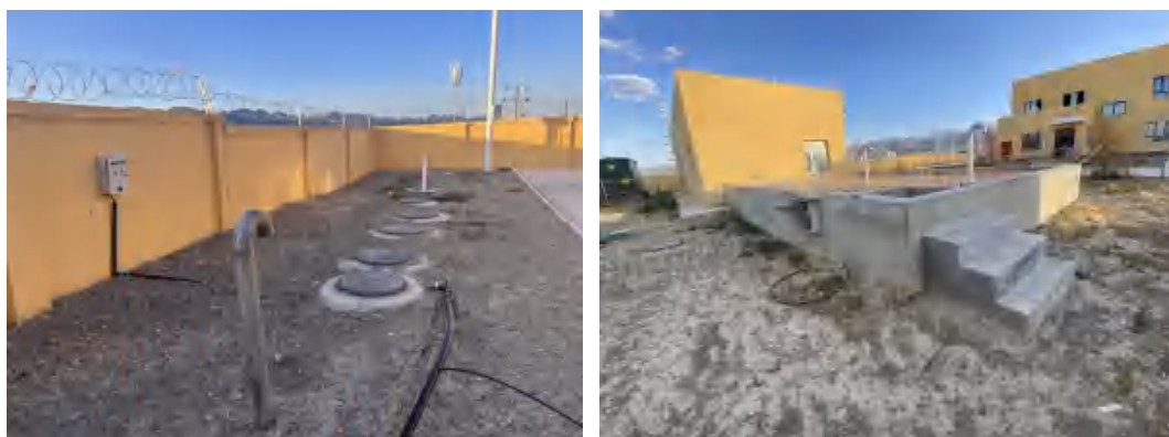
伊吾互通匝道收费站污水处理设施
