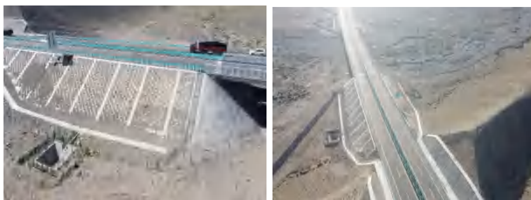
K180+210 小白杨沟 2 号大桥径流收集系统、事故池与防撞护栏
