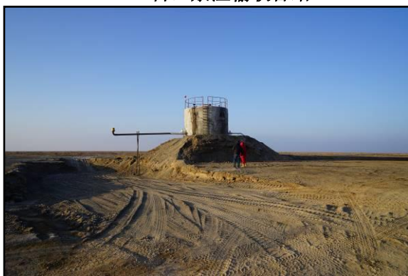
井区已建单井拉油罐
