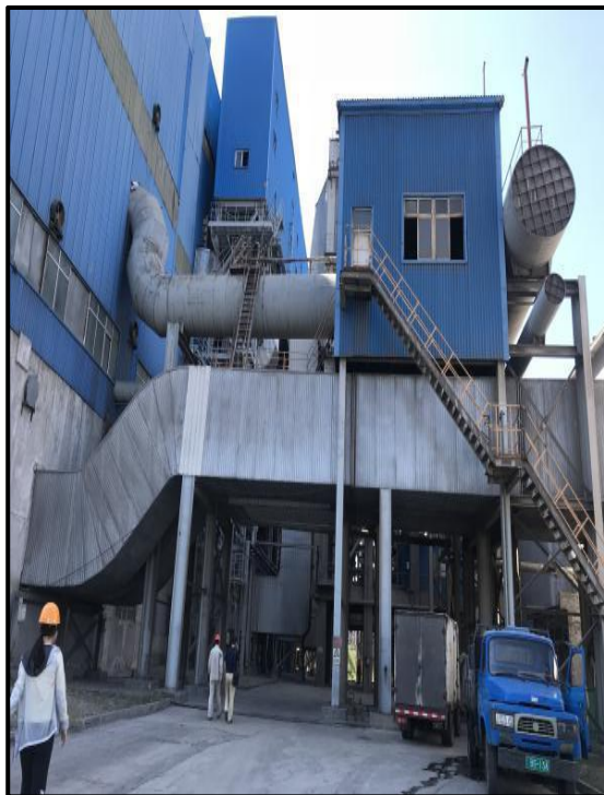
220t/h 燃气锅炉烟气管道
