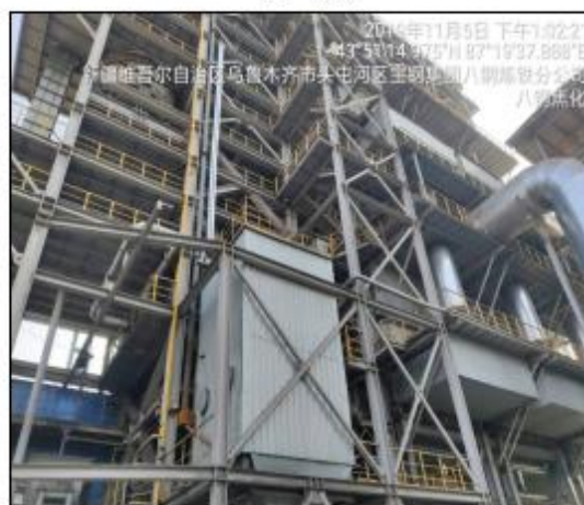
逆流活性炭脱硫脱硝装置
