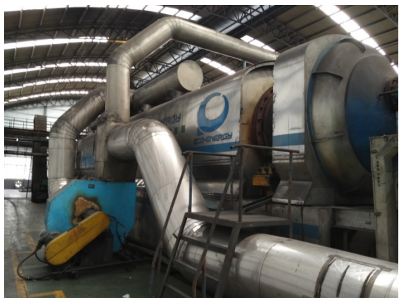
设备主体——热解炉
