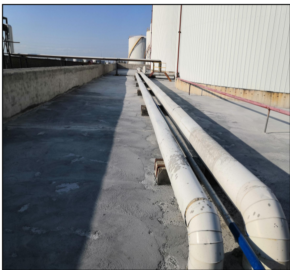
罐区及防火堤
