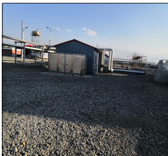
泵房及油气回收装置
