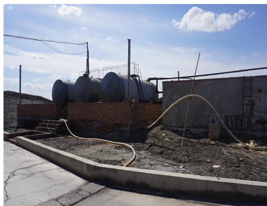
地面回用水罐
