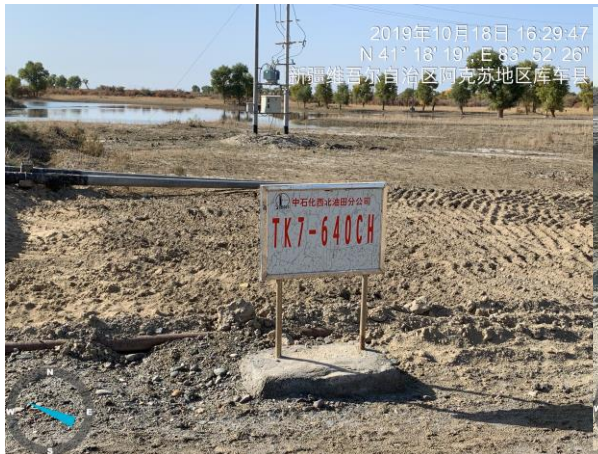
井场附近供电线路
