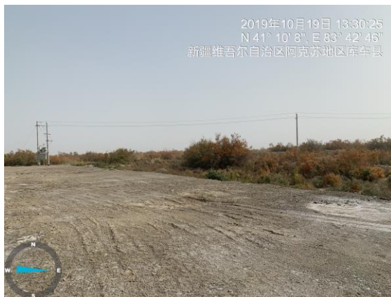
井场附近供电线路
