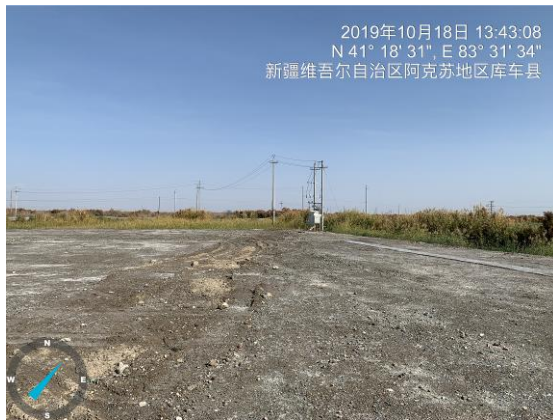
TH10376CX 井电力线
