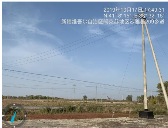
TP198H 井电力线
