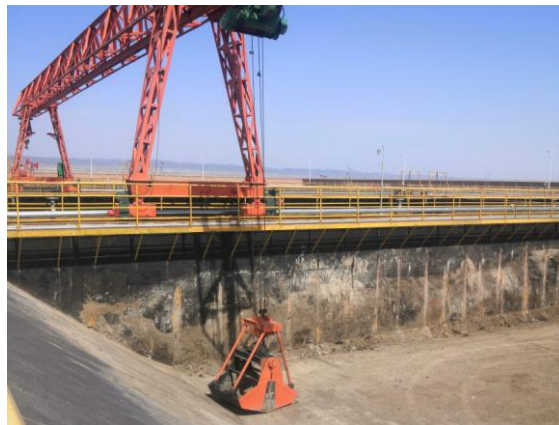
油泥装车设施
