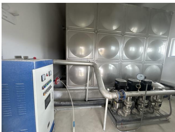
努尔加服务区污水处理设备
