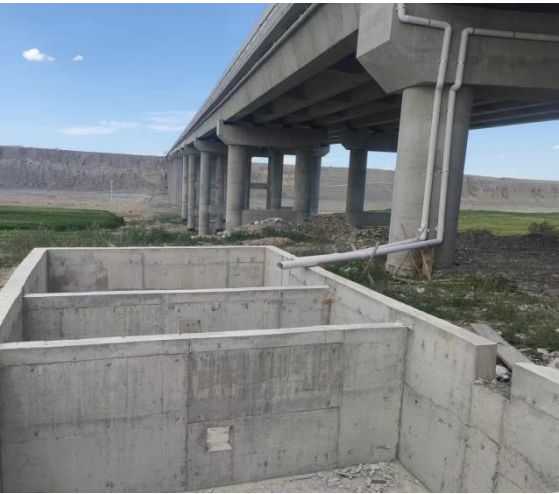
呼图壁河大桥桥面径流收集系统、应急事故池
