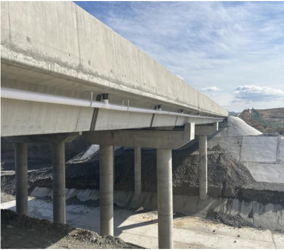
五工台中桥桥面径流系统及排水沟
