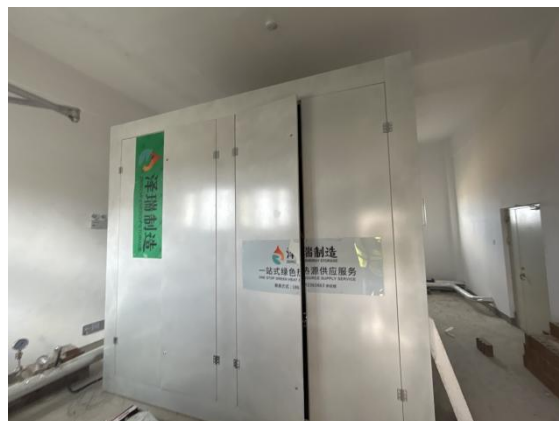
呼图壁主线收费站电锅炉
