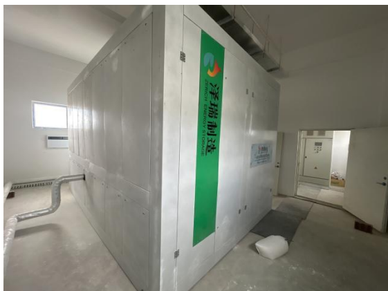
努尔加服务区电锅炉
