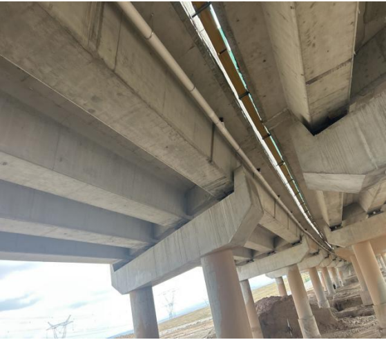
石河大桥桥面径流收集系统
