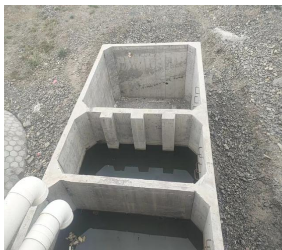
雀尔沟大桥桥面径流收集系统及应急事故池
