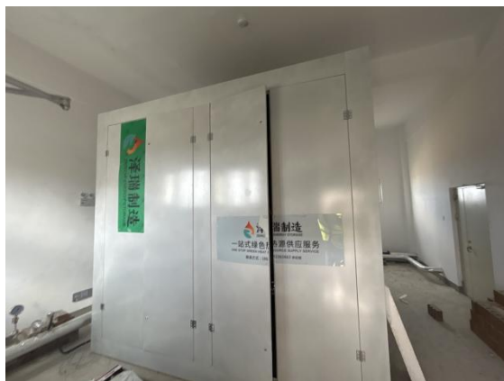
呼图壁主线收费站电锅炉
