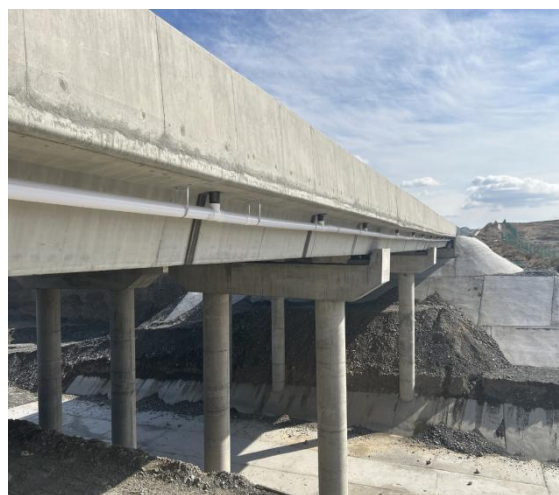
五工台中桥桥面径流系统及排水沟
