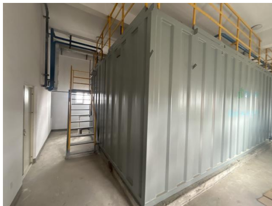
呼图壁主线收费站污水处理设备
