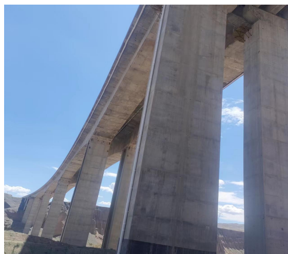
三屯河大桥桥面径流系统
