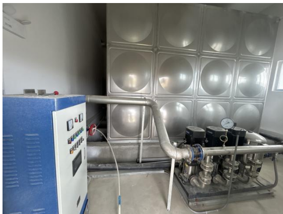
努尔加服务区污水处理设备
