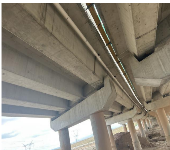
石河大桥桥面径流收集系统
