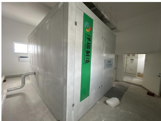
努尔加服务区电锅炉
