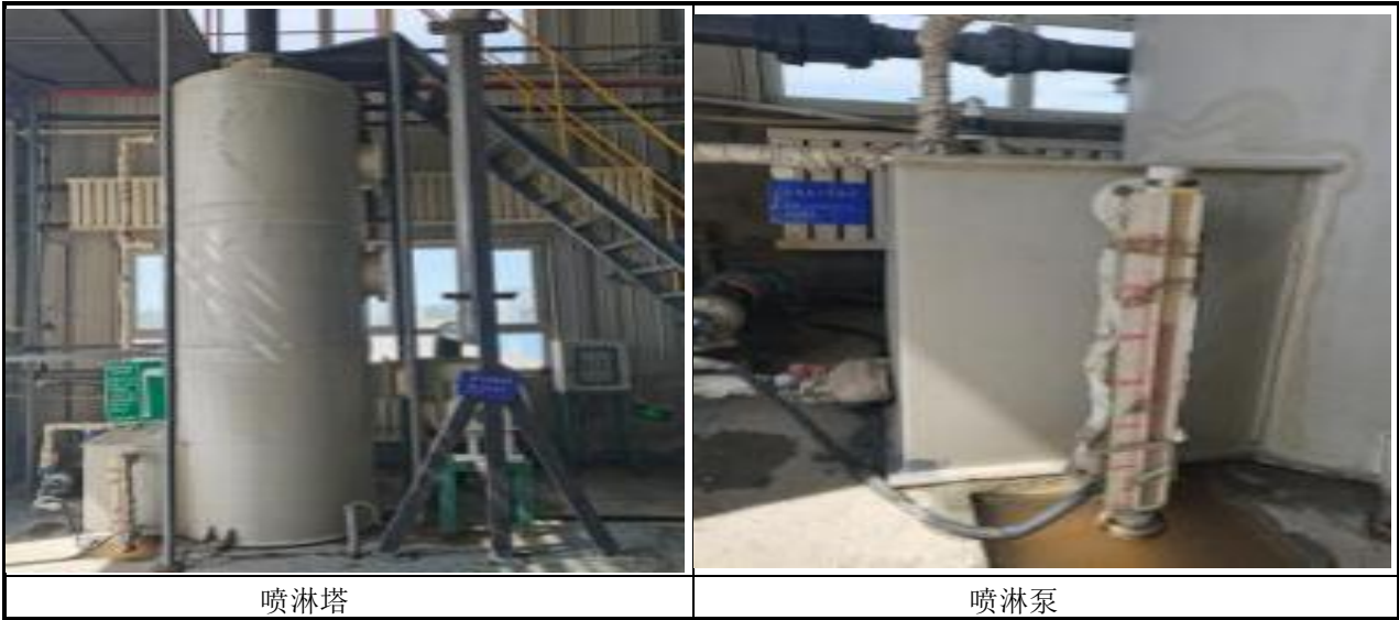
图3. 1-5物化车间废气治理设施照片
