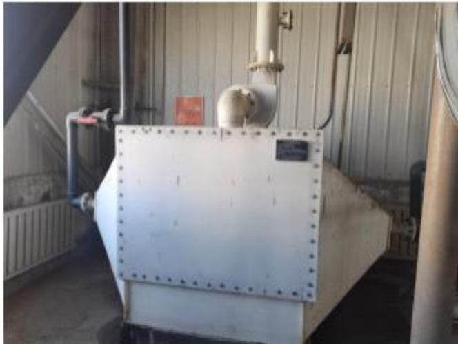
图3. 1-7资源化车间活性炭吸附装置照片
