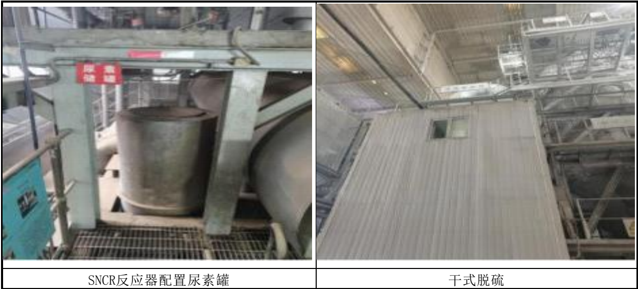
图3. 1-4焚烧烟气治理设施照片
