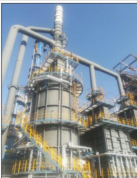
加热炉排气筒 DA002
