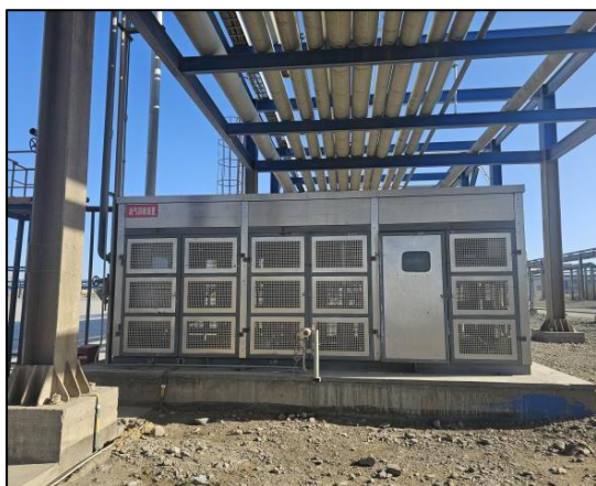
油气回收装置
