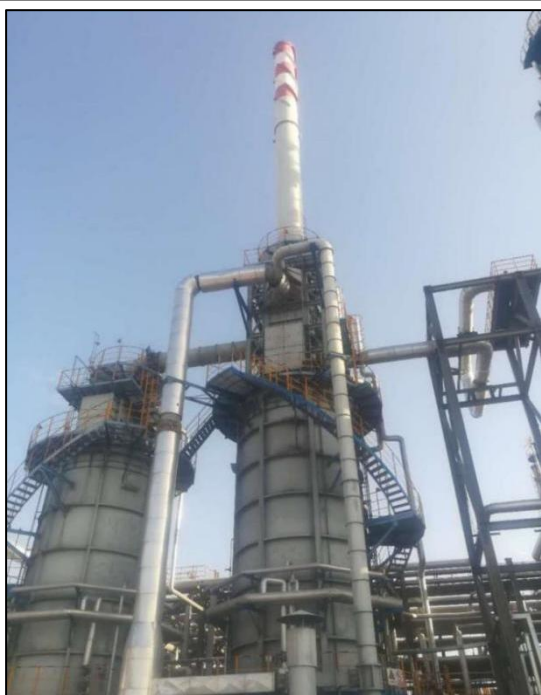
加热炉排气筒 DA001
