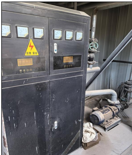
电磁热水锅炉照片
