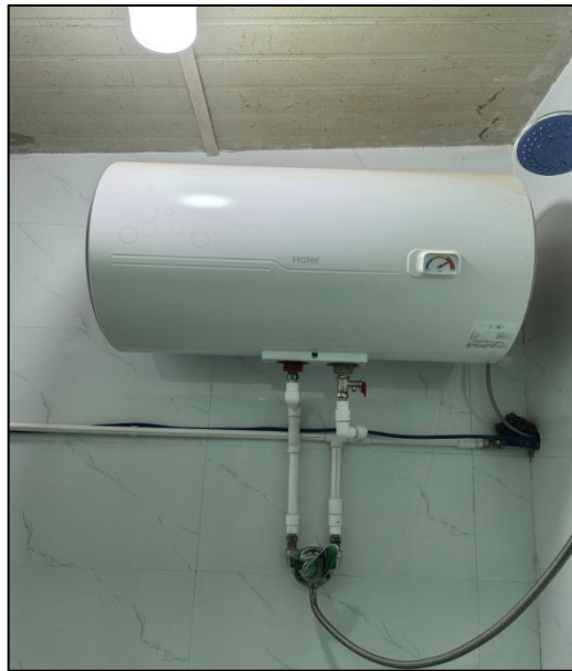
电磁热水锅炉照片
