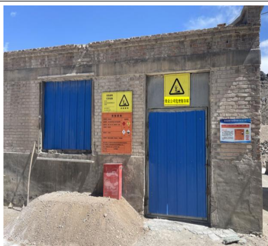
危废暂存库照片
