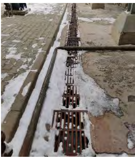
40 万吨/年汽油醚化装置雨水明沟
