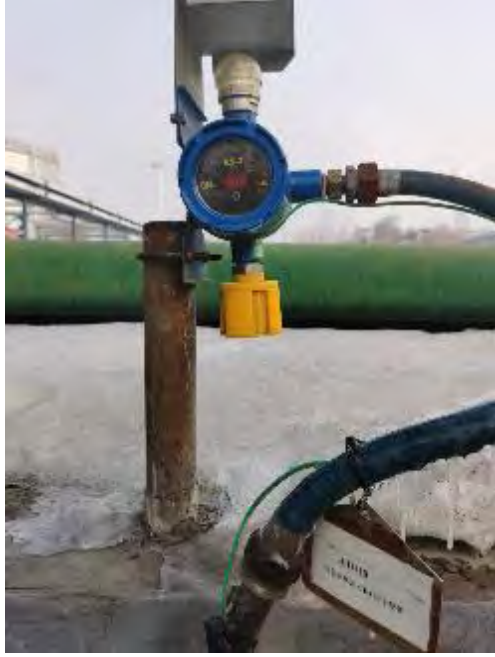
公用工程部隔油池现场甲烷报警器
