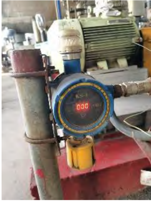
600 万吨/年常减压装置可燃气体报警器
