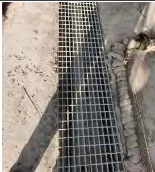
60 万吨/年汽油加氢改质装置雨水明沟
