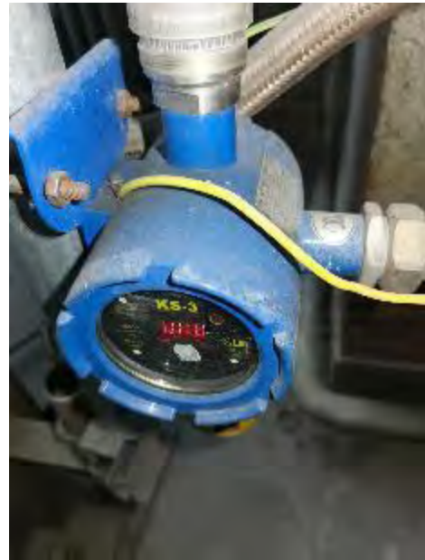
200 万吨/年柴油加氢精制装置泵房可燃气体报警器
