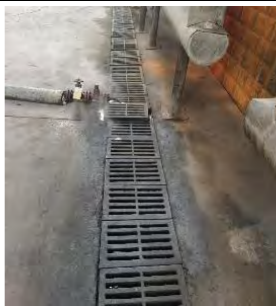
120 万吨/年延迟焦化装置雨水明沟
