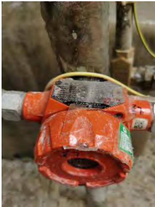
150 万吨/年重油催化裂化装置可燃气体报警器
