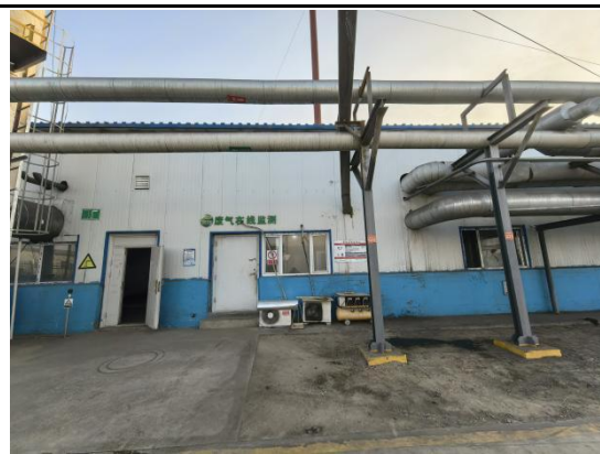
废气在线监测设施
