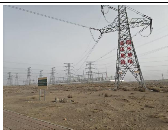
园区 220kV 变电站
