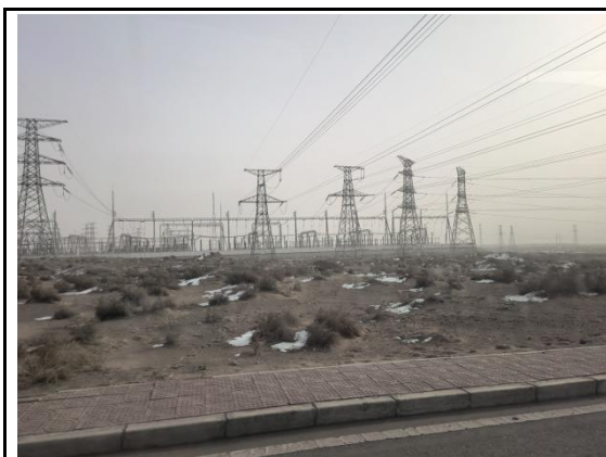
园区 220kV 变电站
