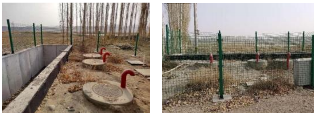
图4.3-1 拜勒其尔村集中化粪池照片
